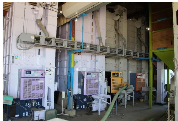
【乾燥機、フレコン設備が設置された作業場】
