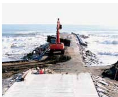
コンクリートは、消耗品
