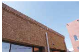
白子町青少年センター (経年劣化による外壁の痛み)
