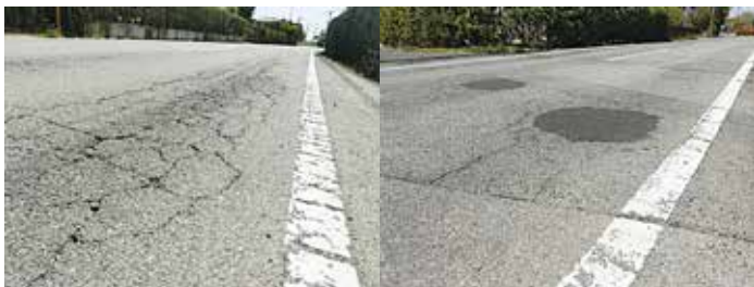
痛みの目立つ舗装道路
