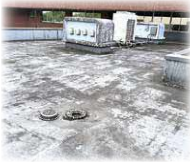
防水工事が必要な役場増築屋上
