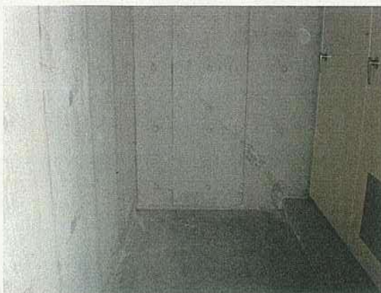
写真 5.3.3 電気室内（PCB 廃棄物保管位置）
